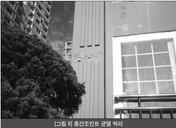
[그림 8] 층간조인트 균열 박리
